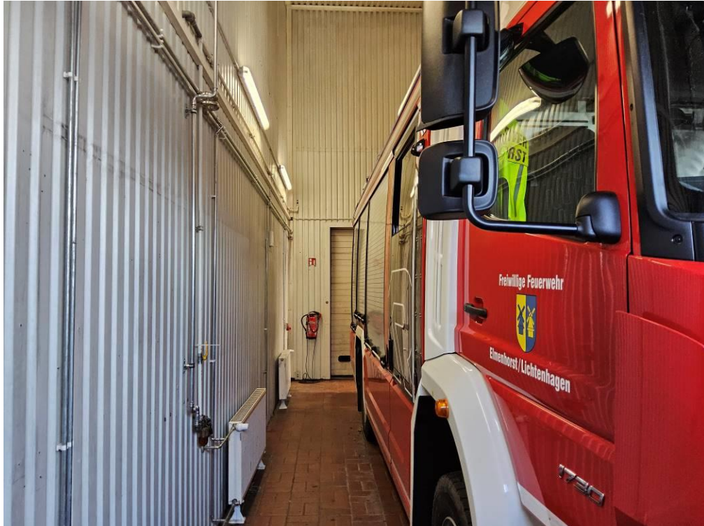
Bild 4: Sicherheitsabstand in der MTW-Halle unterschritten.
