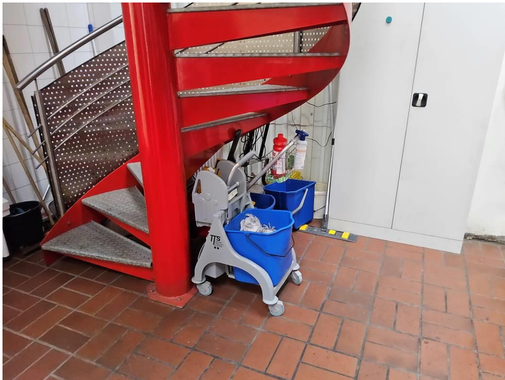
Bild 10: Putzmittel unter Treppe. Kontakt mit Gefahrstoffen (uneingeschränkter Zugriff durch Kinder / Jugend möglich / Jugendfeuerwehr).
