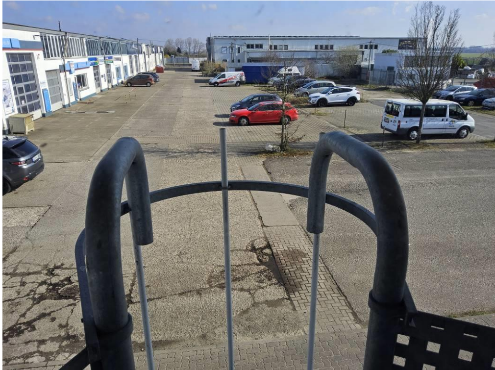
Bild 8: Notausstieg: herausstehende Brüstungsstäbe.
