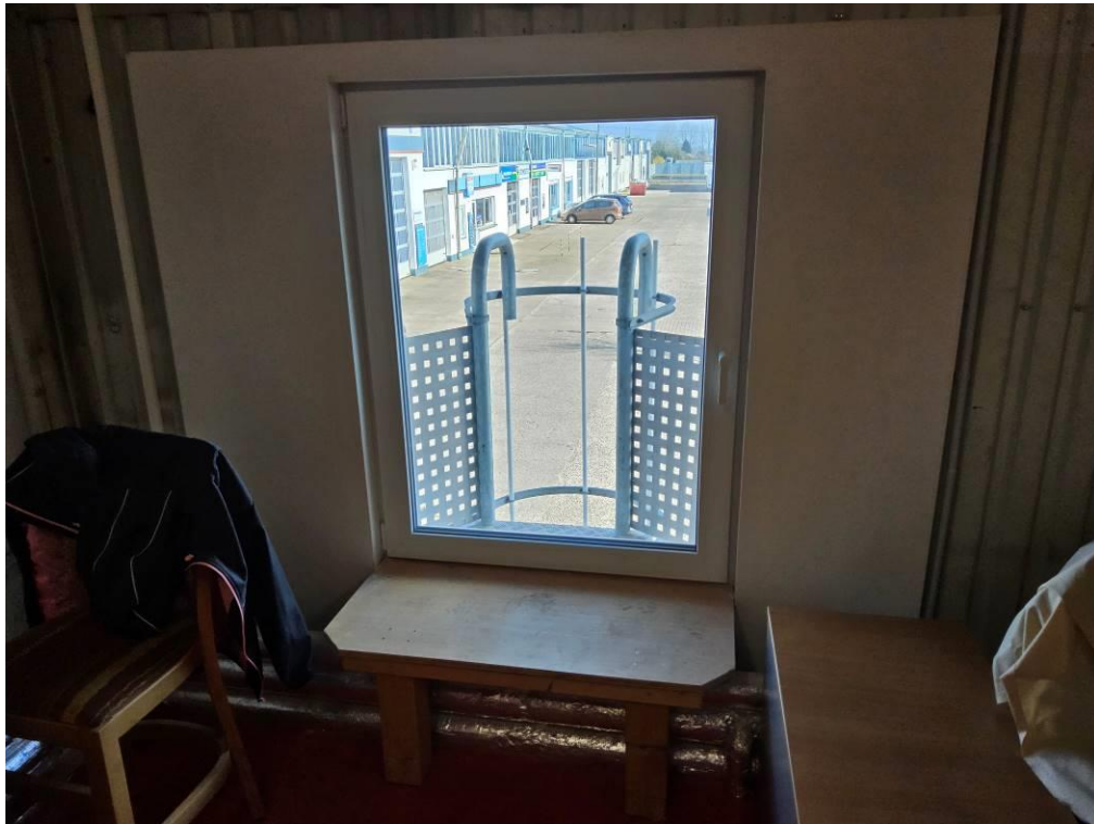
Bild 9: Notausstieg. Ohne geeignete Aufstiegshilfe besteht Sturz- und Stolpergefahr.
