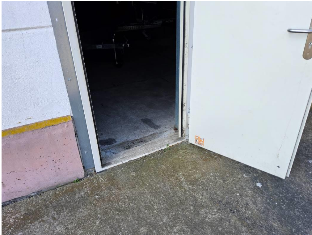
Bild 7: Kalthalle: Eingang Stolperstelle.
