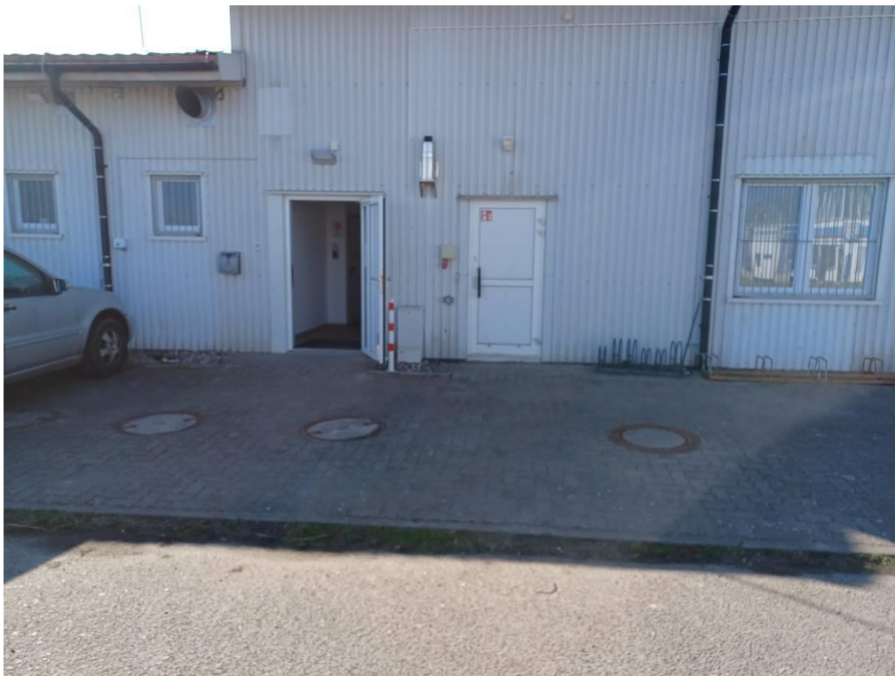
Bild 8: Sperrzone für die Notstromversorgung des Gebäudes ist nicht gekennzeichnet.
