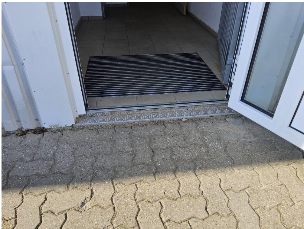
Bild 2: Stolperstelle im Eingangsbereich der Tür (Türschwelle).
